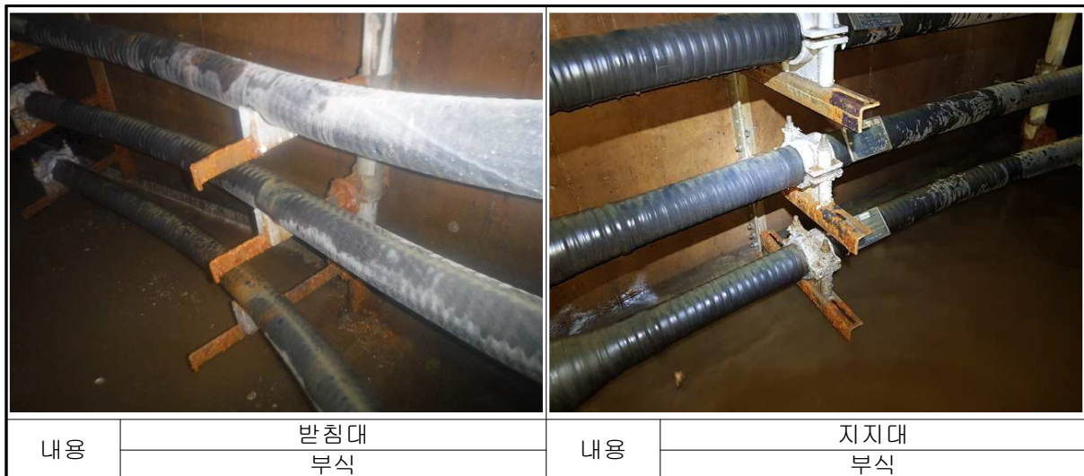
【사진 12.32】 부속 및 부대설비 현황
