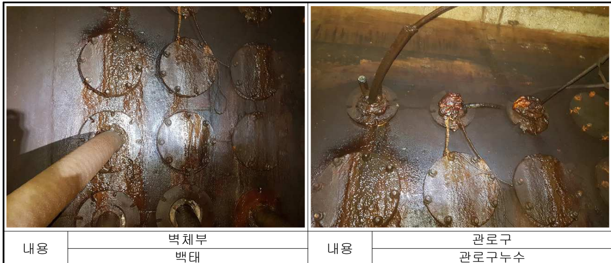
【사진 12.26】 맨홀 내부 주요 손상
