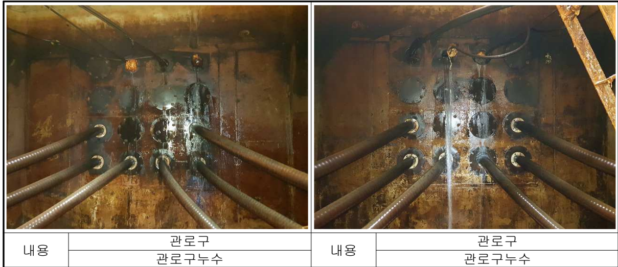
【사진 12.10】 맨홀 내부 주요 손상
