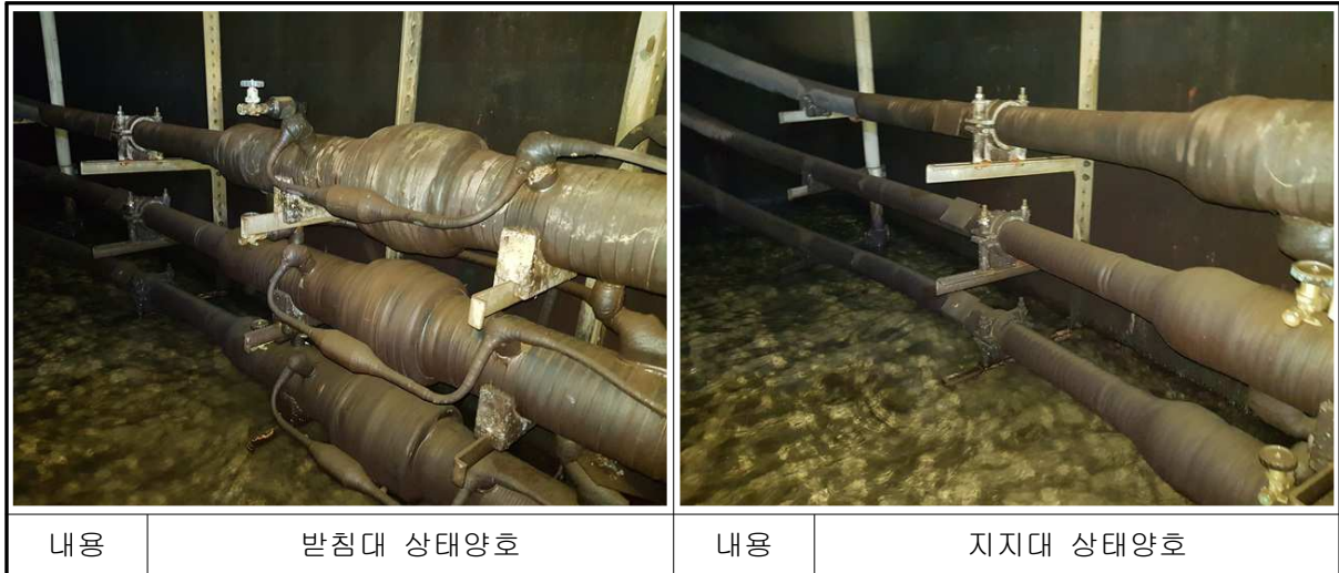
【사진 12.52】 부속 및 부대설비 현황
