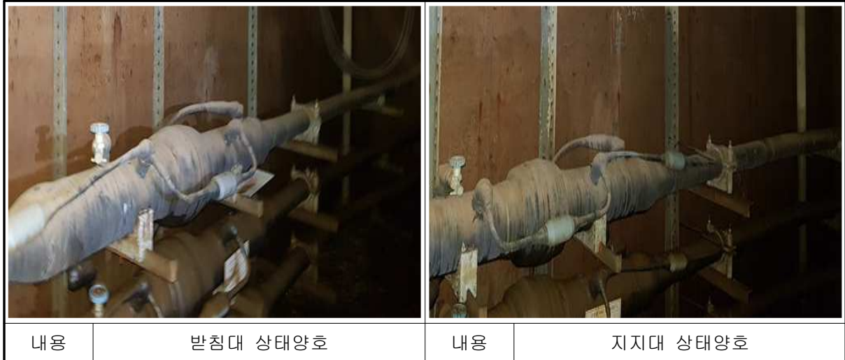
【사진 12.56】 부속 및 부대설비 현황
