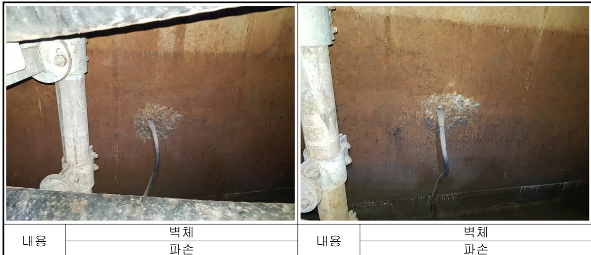
【사진 12.34】 맨홀 내부 주요 손상
