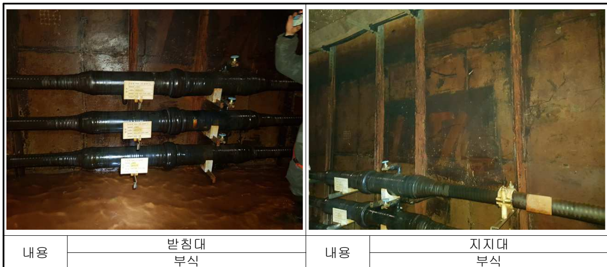
【사진 12.12】 부속 및 부대설비 현황
